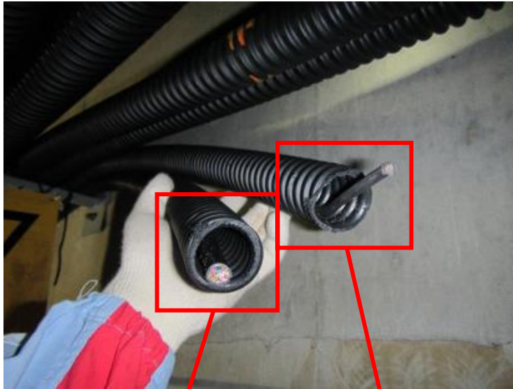
伊方発電所 3号機 火災感知器のケーブル切断箇所復旧写真
