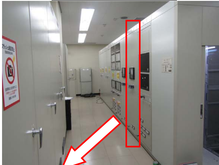
所内変圧器制御補助盤
