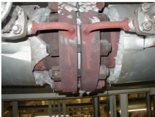
湿分分離加熱器加熱蒸気配管の オリフィス取付用フランジ部
