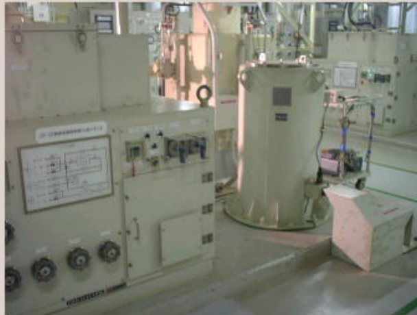
伊方2号機格納容器排気筒じんあいモニタ（左）及びガスモニタ（右）
