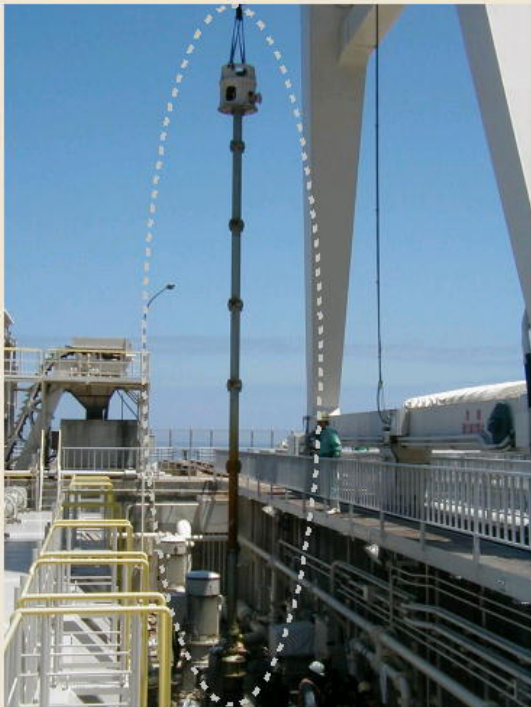
電解揚水ポンプ（全体）
