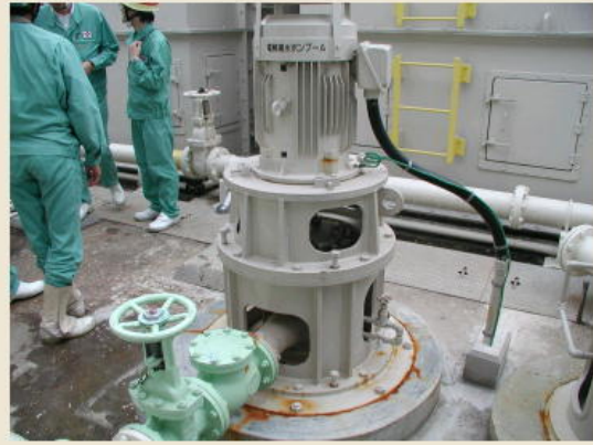
電解揚水ポンプ（モーター部）
