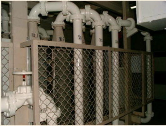
海水電解装置（電解槽）
