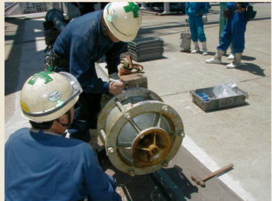
電解揚水ポンプ（ポンプ先端）
