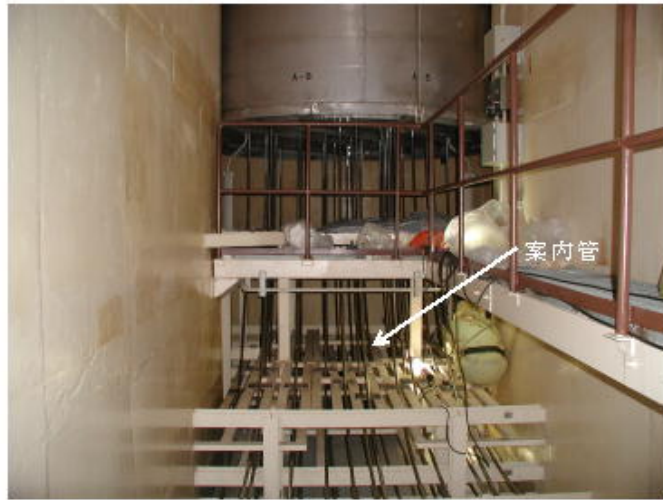
原子炉容器下部全景
