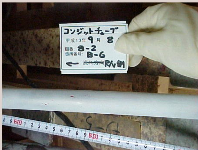
案内管液体浸透探傷検査結果（B－6）
