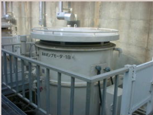
海水ポンプ (モーター部)
