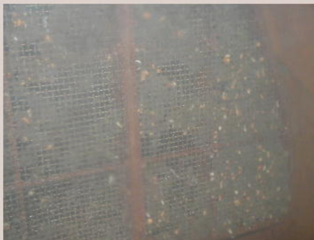
除貝装置 2 D ストレーナ (清掃前)
