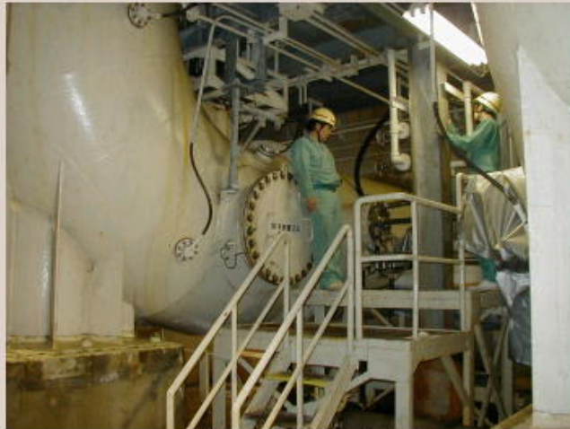
除貝装置外観
