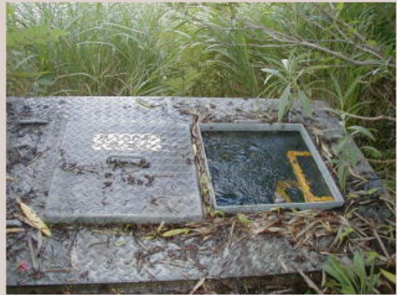
ピット(空気抜き弁設置用)からの漏水状況
