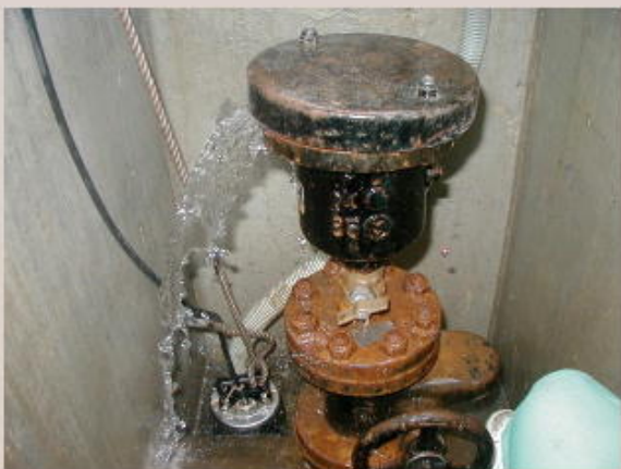
空気抜き弁全体
