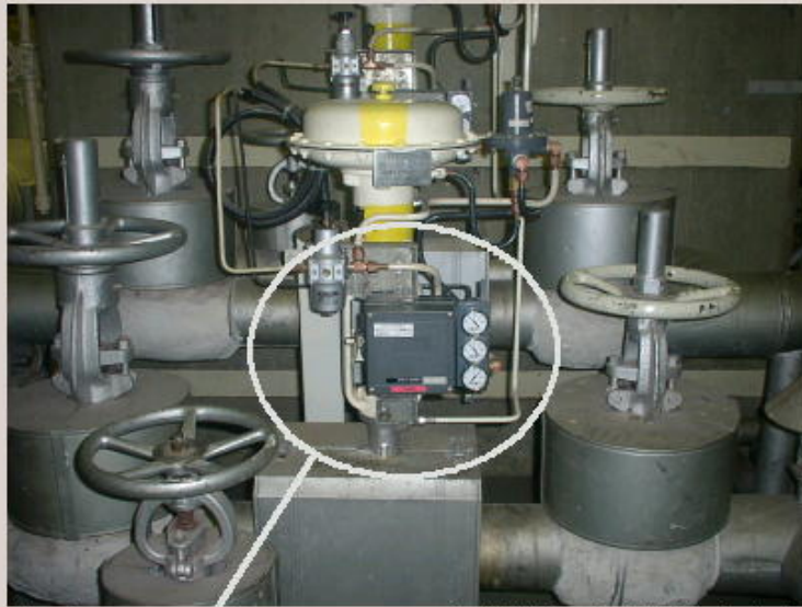
高圧タービンエンドウォール加熱蒸気圧力制御弁全景
