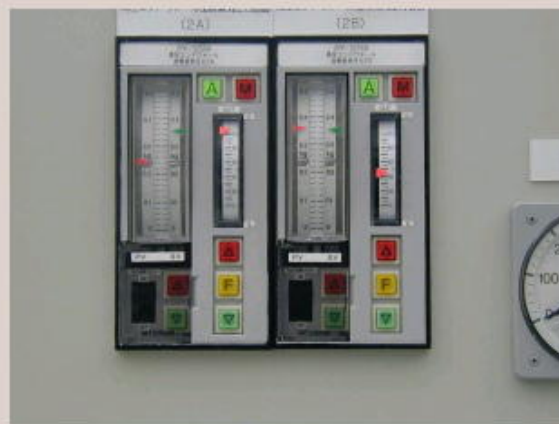
(参考) コントローラ (中央制御室) [左側が圧力低下のあった側]
