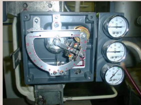
開度調整器内部
