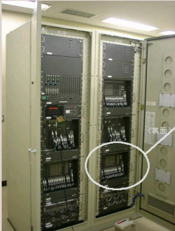
原子炉制御系計器ラック (1次系計装盤室)
