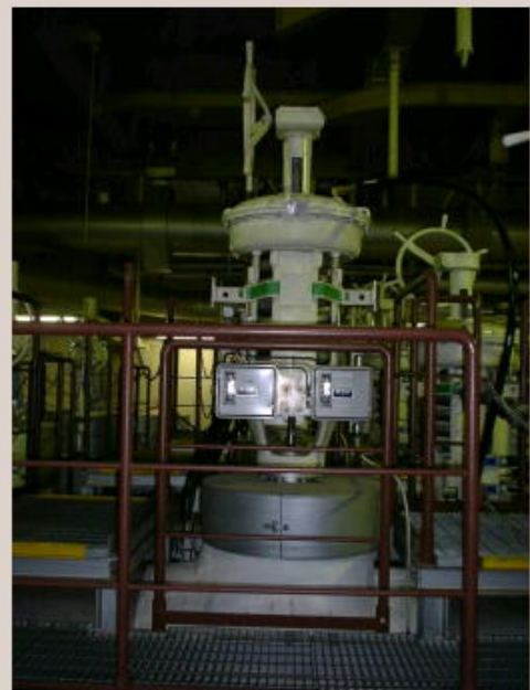
(参考) 主給水制御弁
