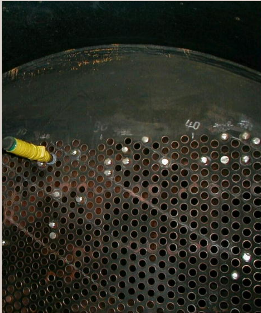
低圧給水加熱器管板部（真空引きによる伝熱管漏えい検査状況） （個々の穴が伝熱管）
