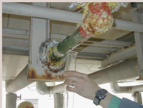
脱気器水面計配管漏えい部 (保温材を除いた状態)
