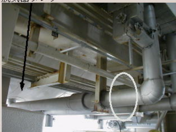
脱気器水面計配管漏えい部
