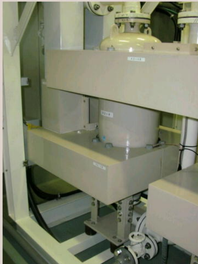
エタノールアミン排水処理装置（電解槽）
