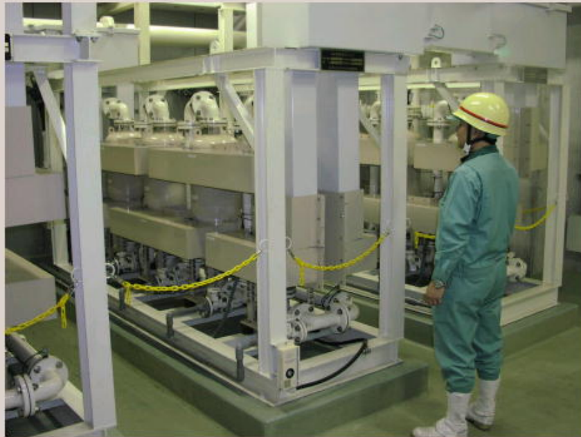
エタノールアミン排水処理装置（全景）
