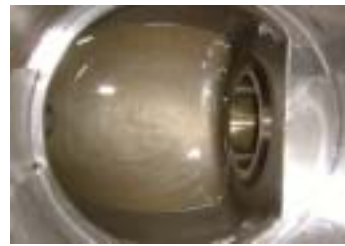
逆止弁 (3V-CS-136C) 異常なし
