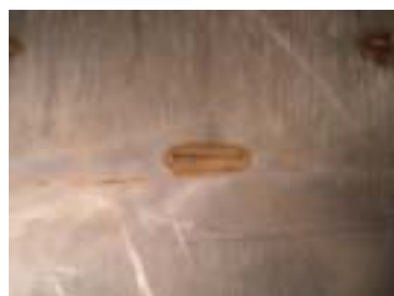
ひび割れ①⑦ (ダクト内面)
