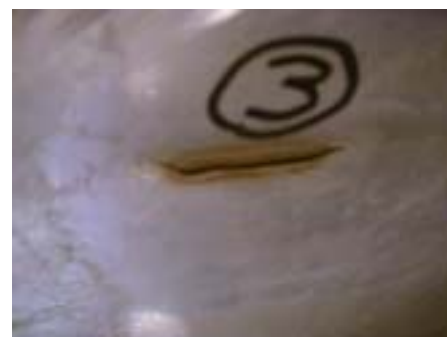
ひび割れ③ (ダクト内面)
