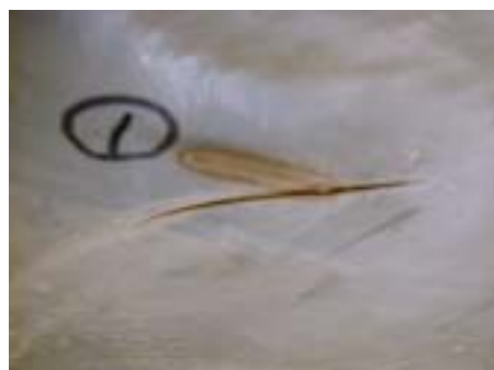
ひび割れ① (ダクト内面)
