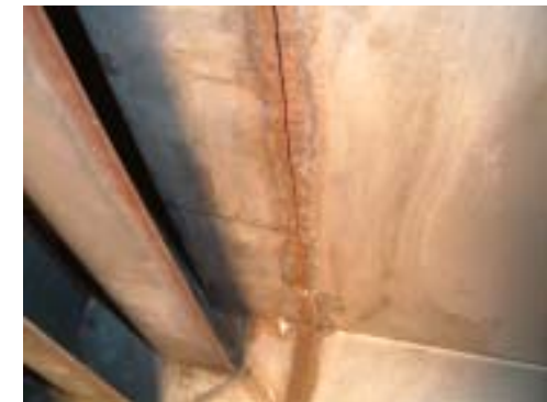
ひび割れ ② (ダクト内面)
