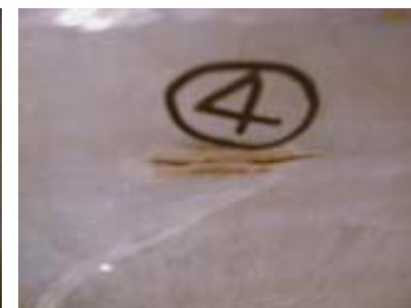
ひび割れ④ (ダクト内面)
