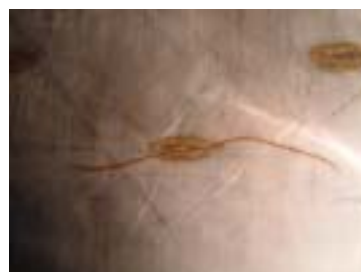
ひび割れ①⑧ (ダクト内面)
