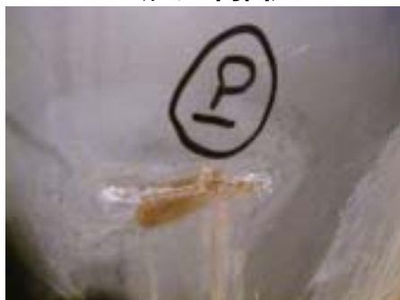
ひび割れ⑨ (ダクト内面)
