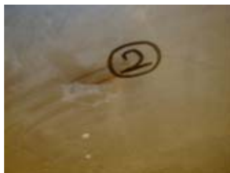
ひび割れ② (ダクト内面)
