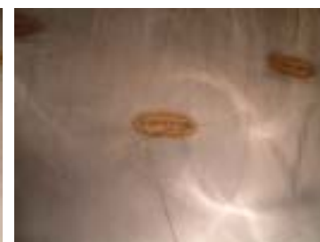
ひび割れ②① (ダクト内面)
