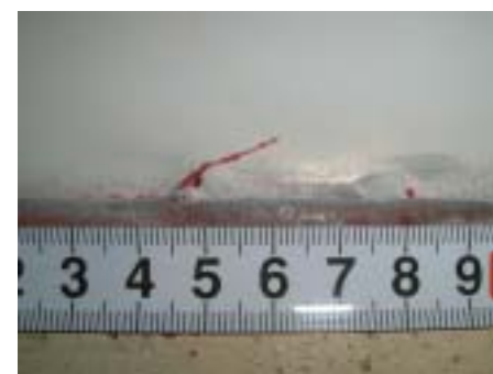
ひび割れ⑮ (ダクト外面)
