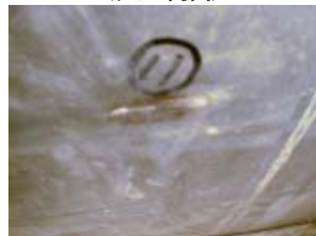
ひび割れ⑪ (ダクト内面)
