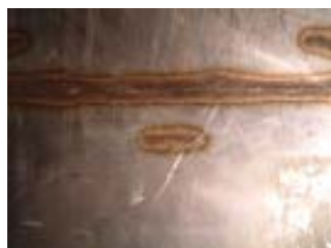
ひび割れ①⑥ (ダクト内面)
