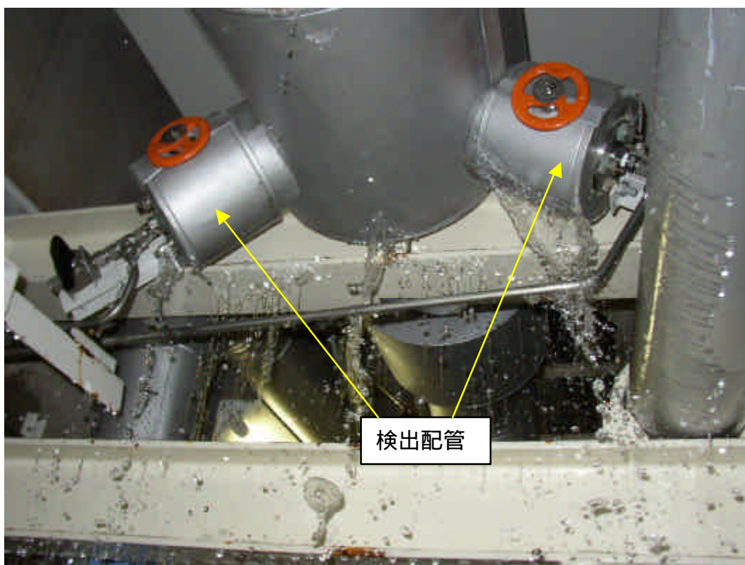
海水漏えい箇所
