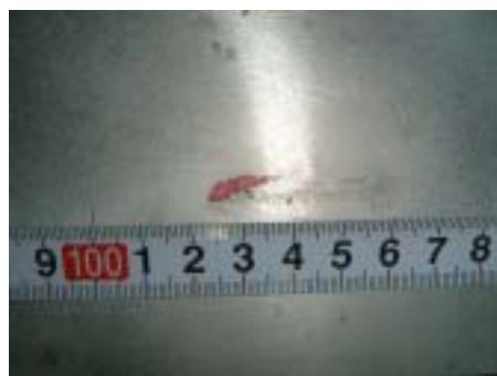
ひび割れ⑬ (ダクト内面)
