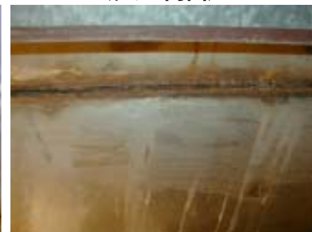
ひび割れ⑫ (ダクト内面)
