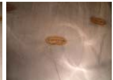
ひび割れ②① (ダクト内面)
