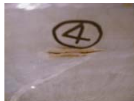
ひび割れ④ (ダクト内面)
