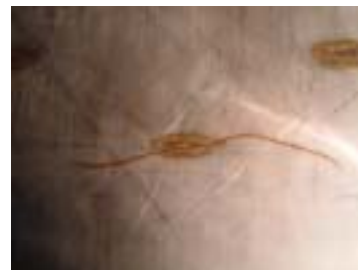
ひび割れ①⑧ (ダクト内面)
