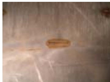
ひび割れ①⑦ (ダクト内面)
