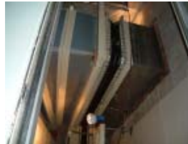
①排気筒水平ダクト部 (原子炉補助建家内)
