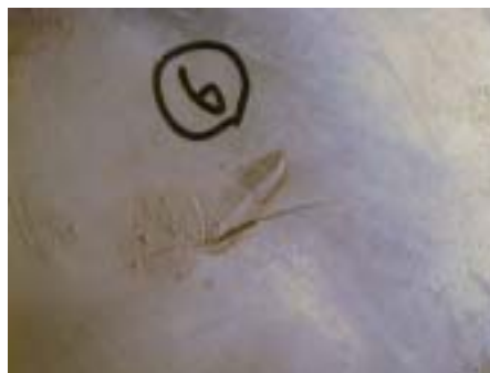
ひび割れ⑥ (ダクト内面)
