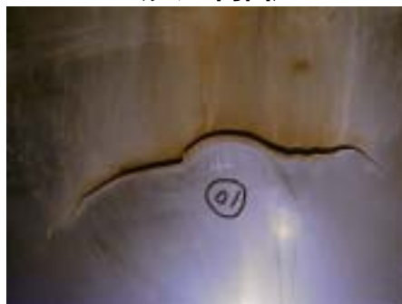
ひび割れ⑩ (ダクト内面)
