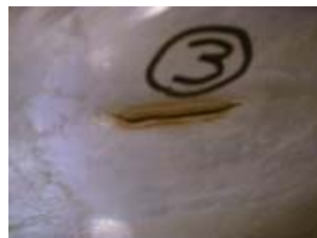
ひび割れ③ (ダクト内面)
