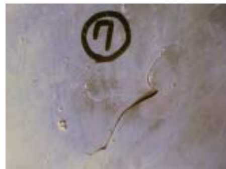
ひび割れ⑦ (ダクト内面)
