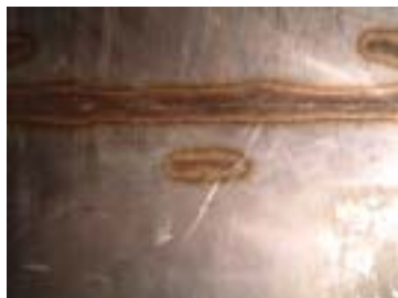
ひび割れ①⑥ (ダクト内面)
