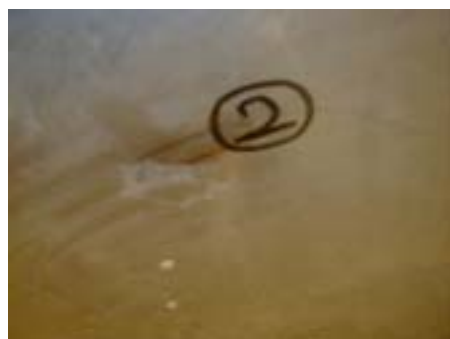
ひび割れ② (ダクト内面)
