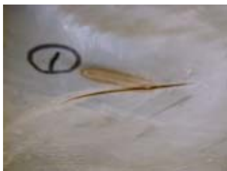
ひび割れ① (ダクト内面)
