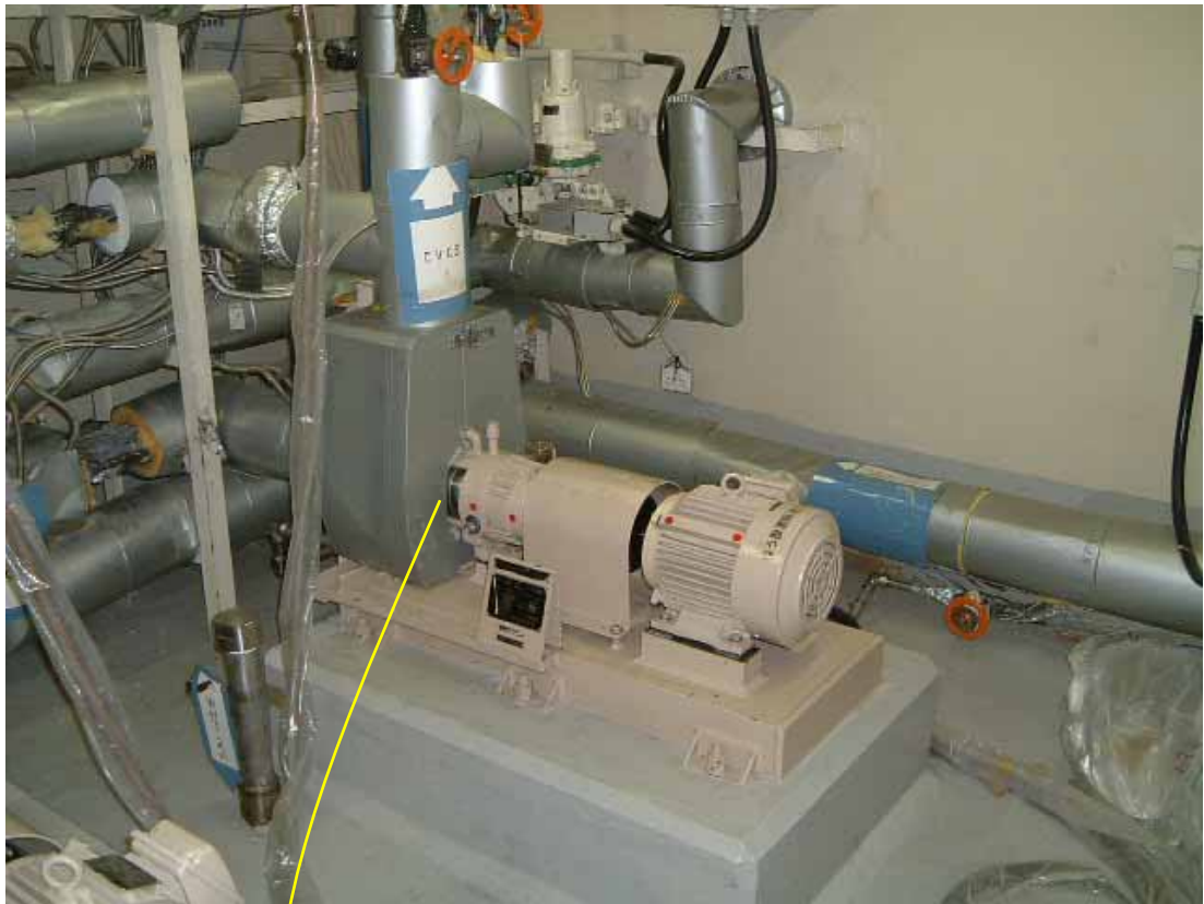
ほう酸濃縮液ポンプ全景
