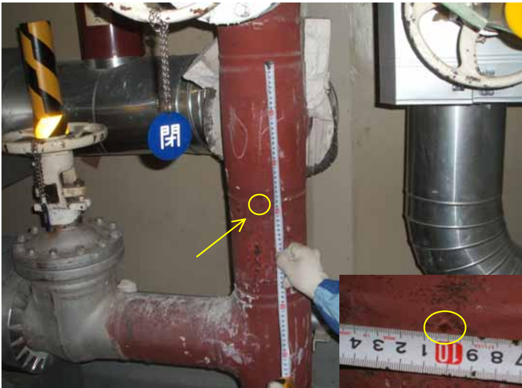
補助蒸気配管漏えい箇所 (保温材を外した状態)
