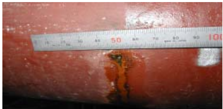
消火ポンプB 出口配管漏えい箇所
