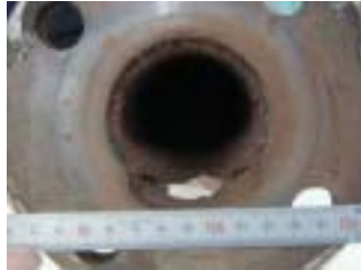
配管フランジ面側から (手入れ後)
