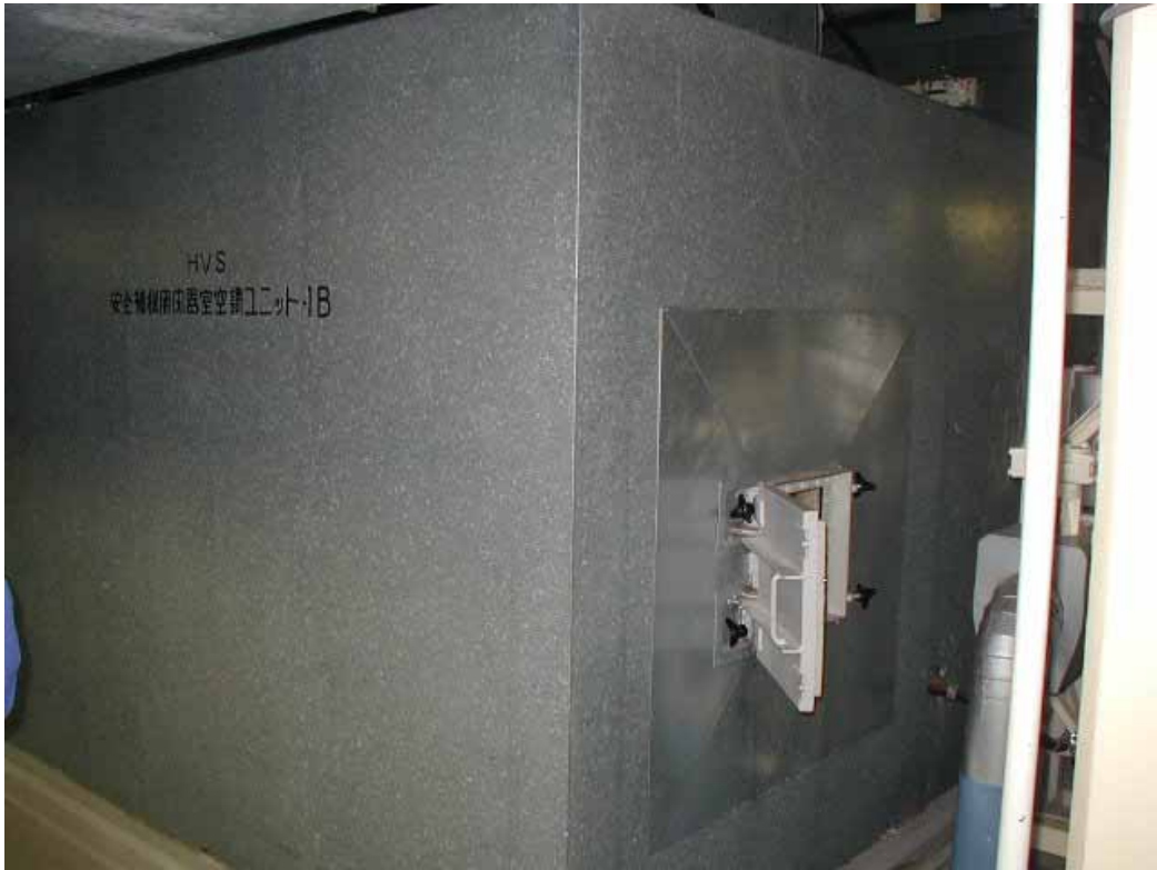
安全補機開閉器室空調ファンBユニット
