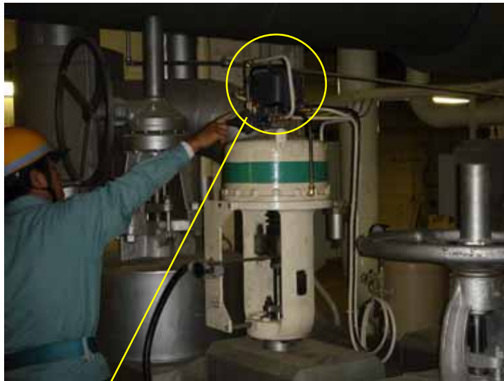
脱気器加熱蒸気圧力制御弁
