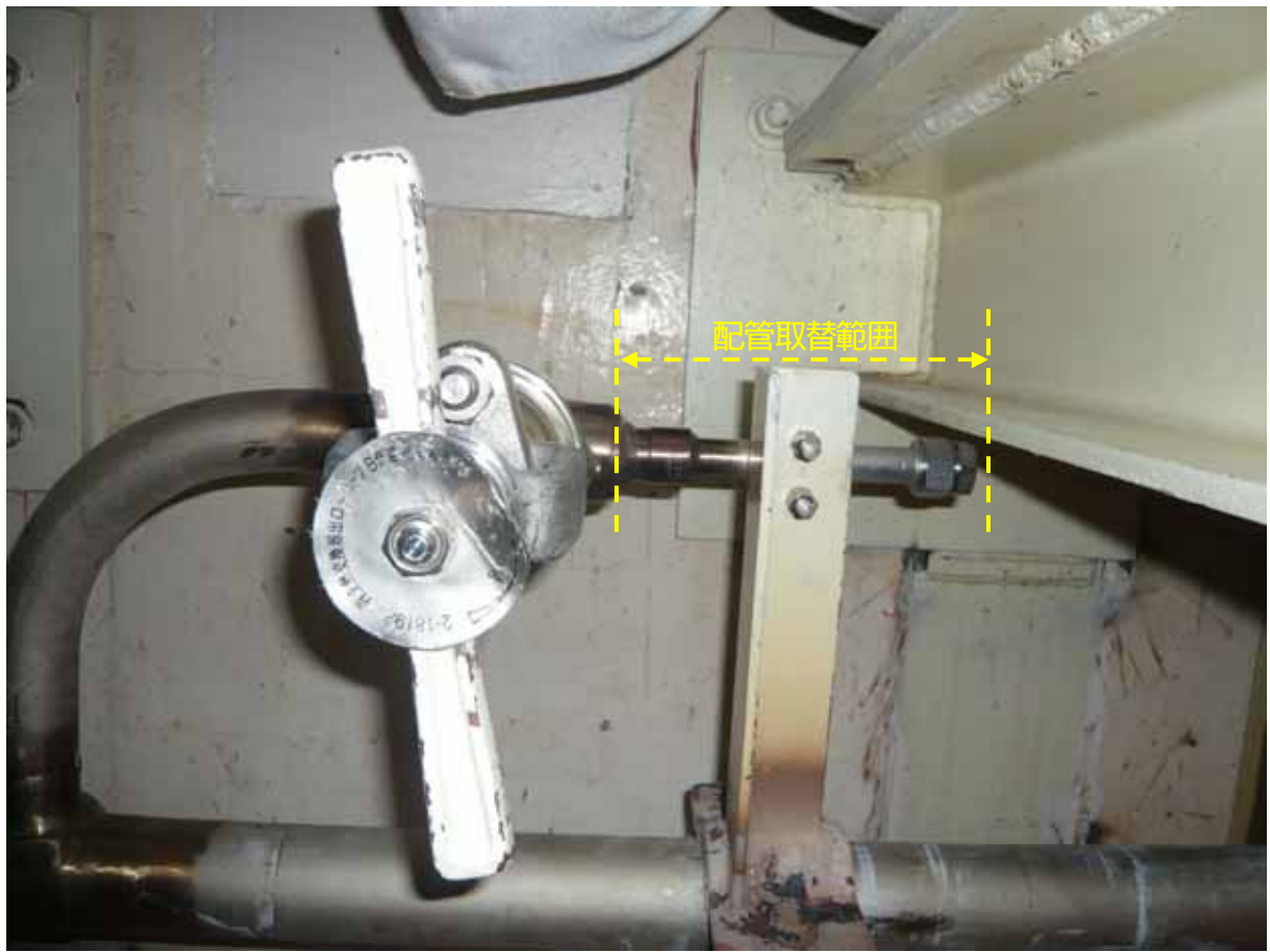
充てんラインベント弁周辺
