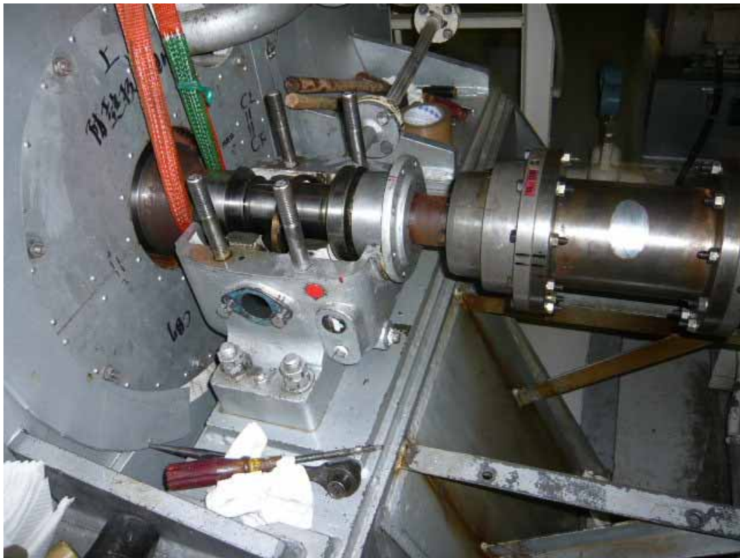
排ガスパロア軸受部状況(モーター側)
