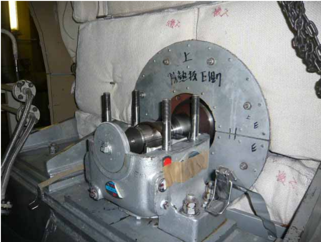
排ガスフロア軸受部状況(軸端側)
