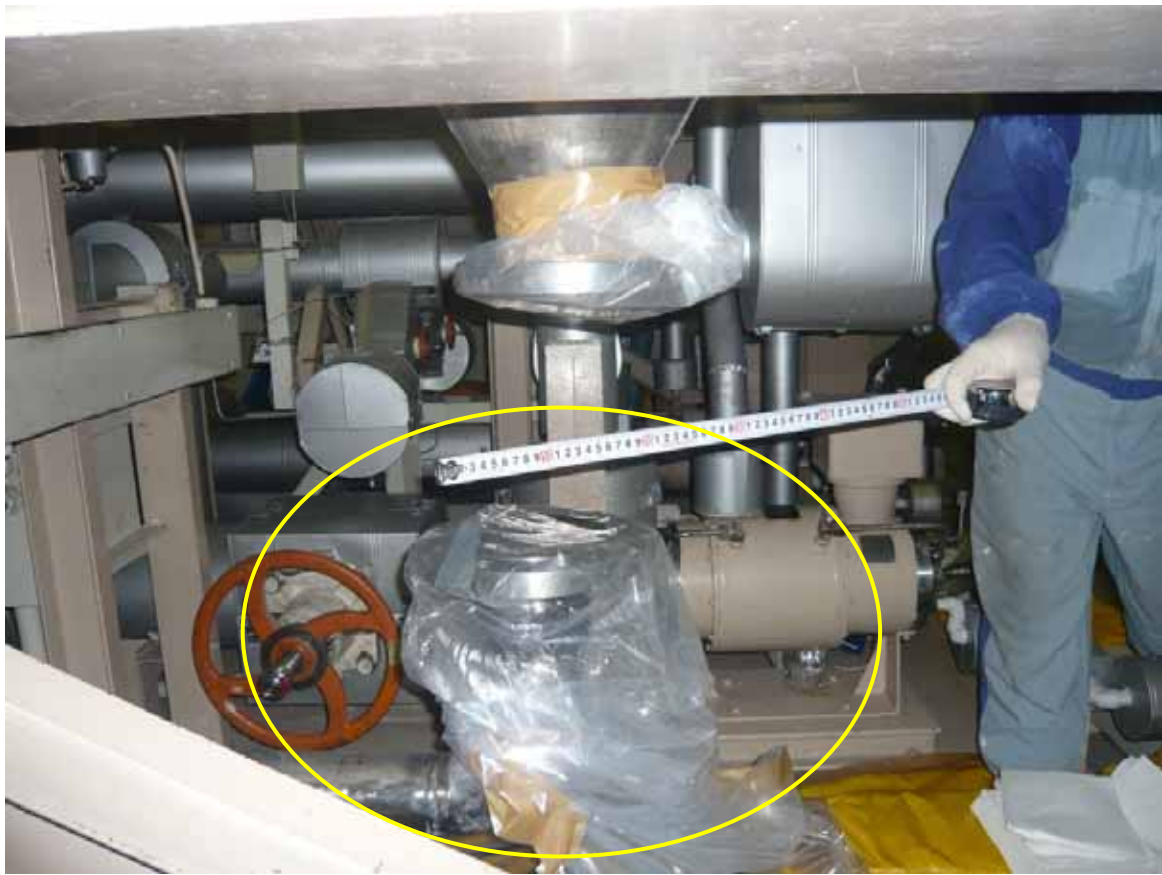
配管フランジ
