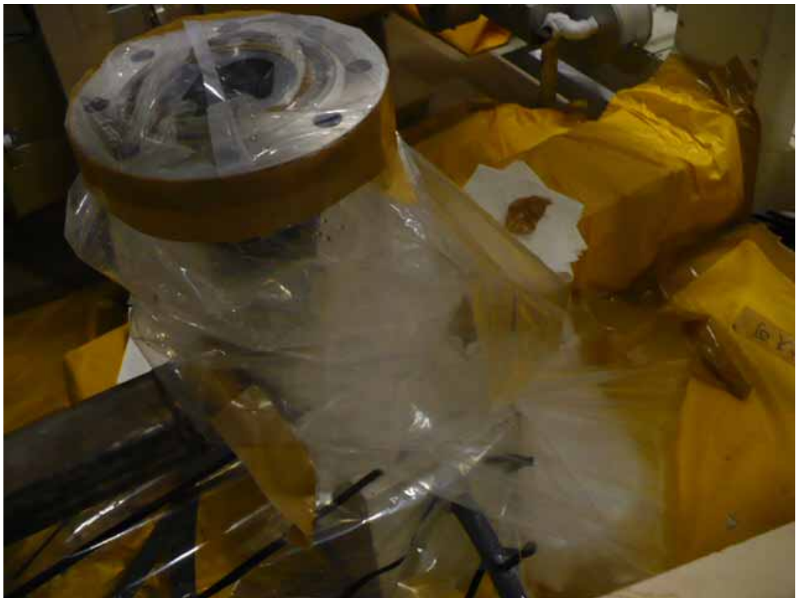
配管フランジ
