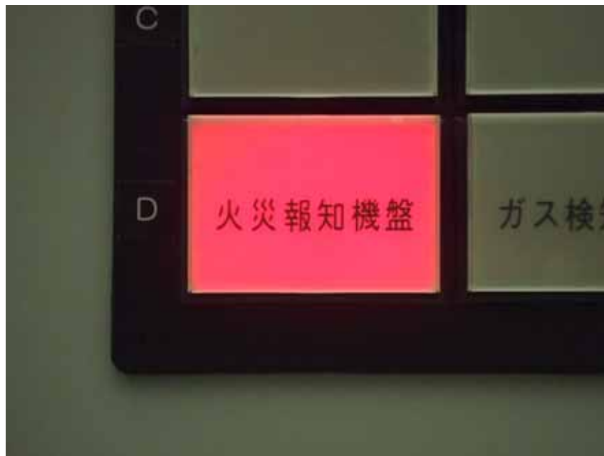
中央制御室警報発信状況
