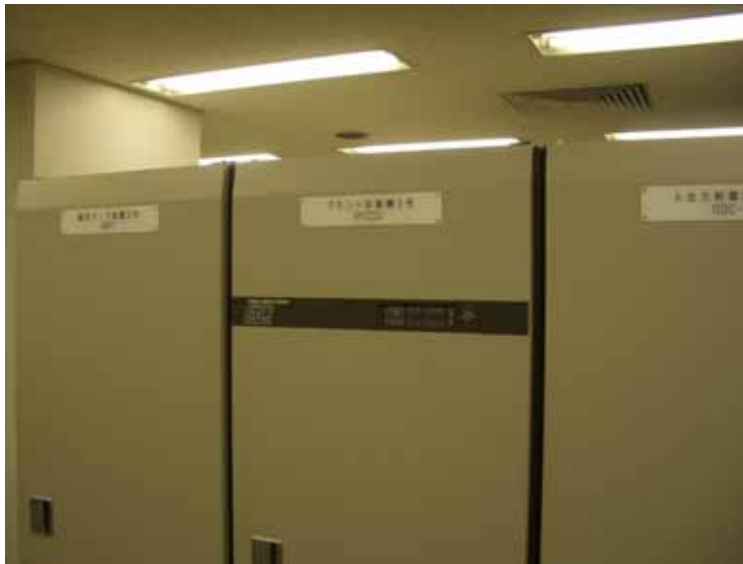
プラント計算機本体
