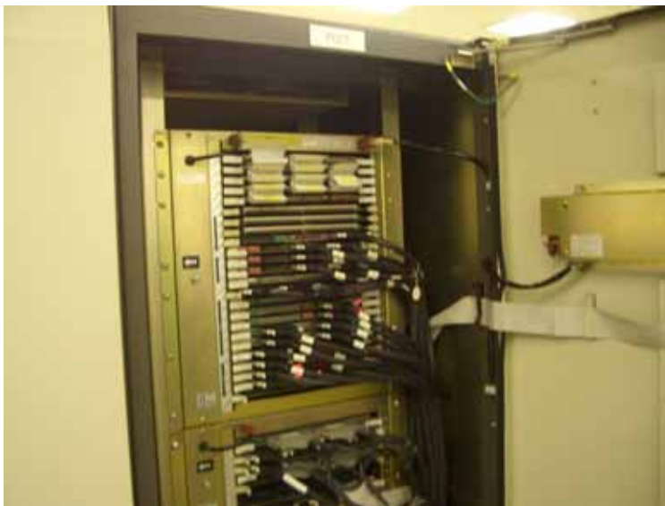
プラント計算機内部
