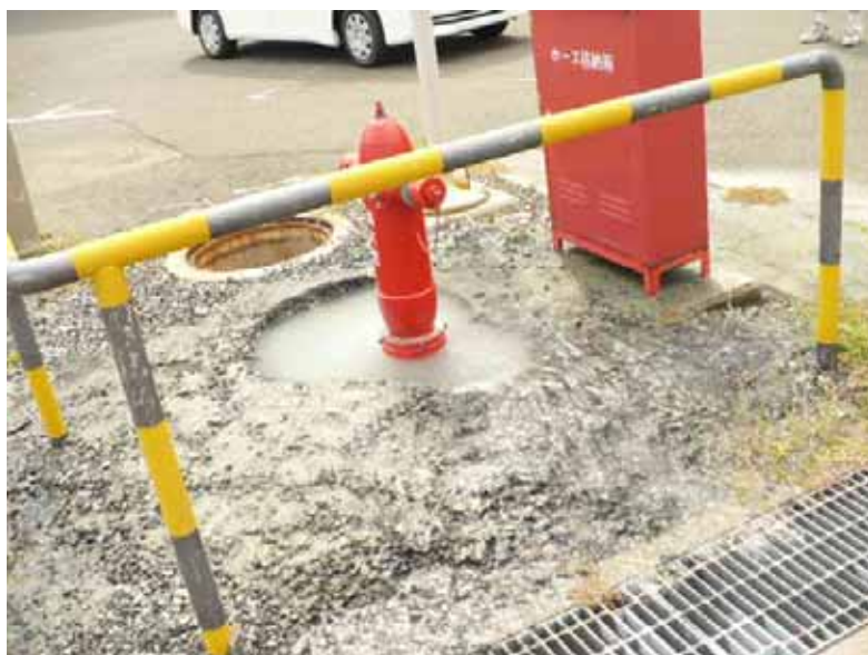
水漏れの状況
