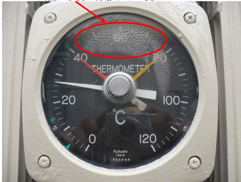
予備変圧器ダイヤル温度計外観
