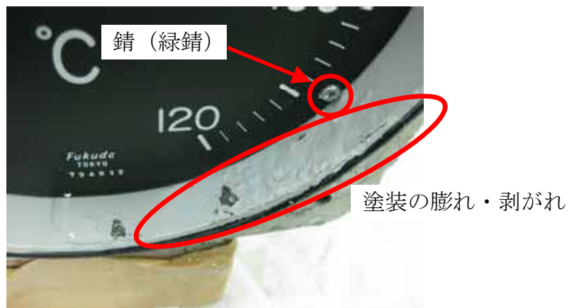
予備変圧器ダイヤル温度計本体ケース内面
