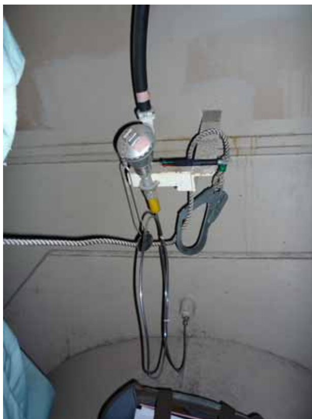
温度計 (検出部は復水器の内側に設置されている)
