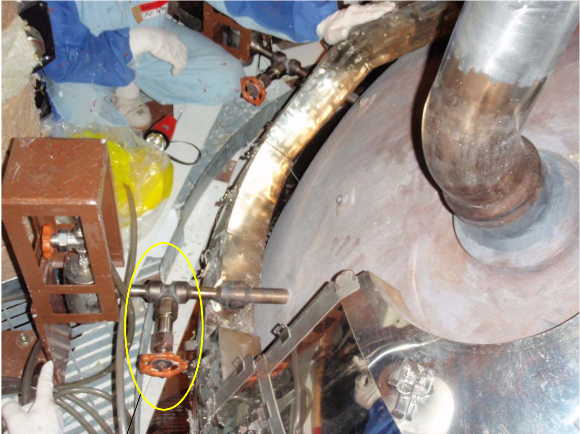
加圧器水位計の検出器元弁
