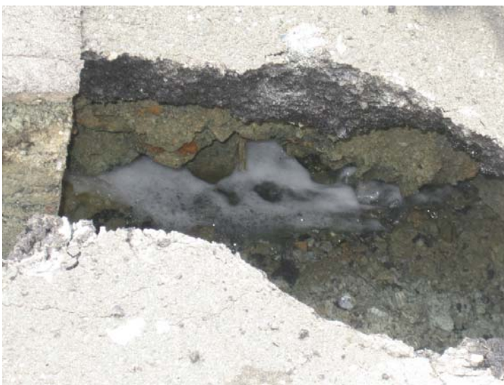
陥没内部の海水漏れ
