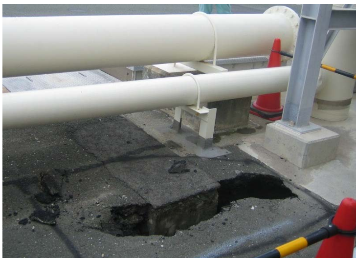
陥没の状況 (穴の大きさ: 140cm × 70cm)
