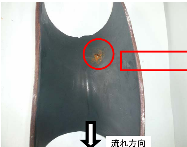
漏えい箇所写真(内面)
