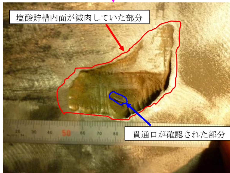
貫通穴の状況
