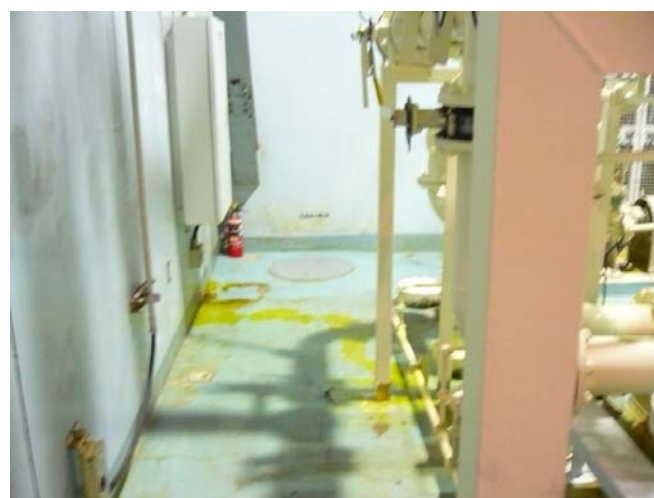
塩酸漏えい状況
