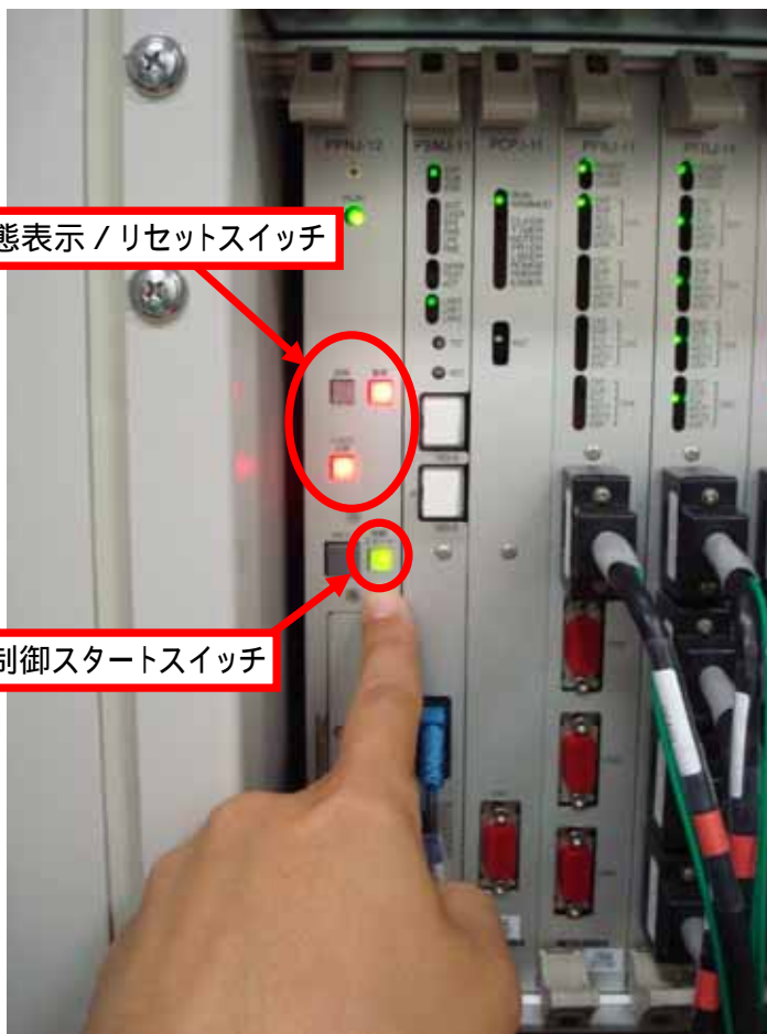
安全防護系シーケンス盤(状態表示パネル)
