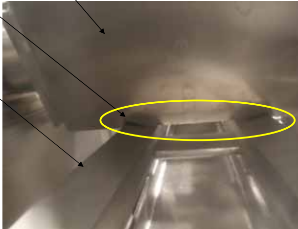
リフティングフレームの変形状況（反燃料移送管側より）
