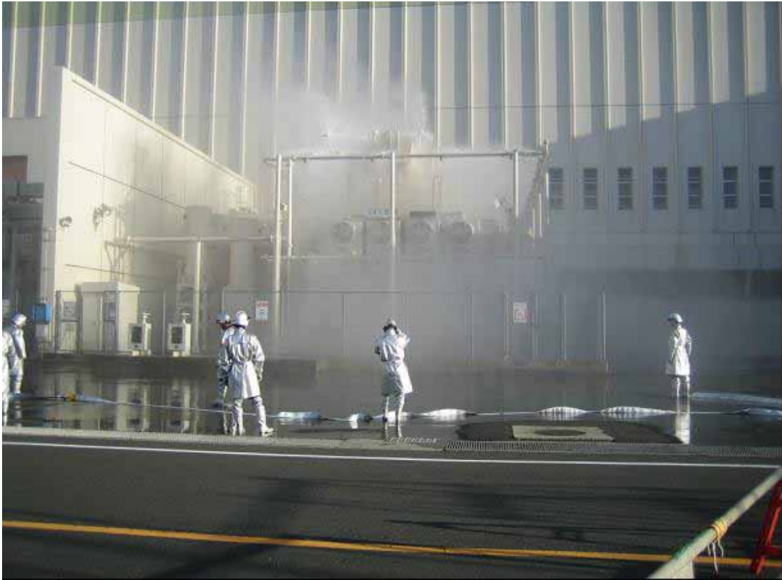
水噴霧消火装置動作状況
