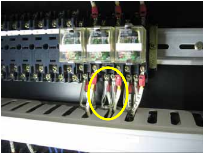
排気ファン 3 B の サージキラー取替後
