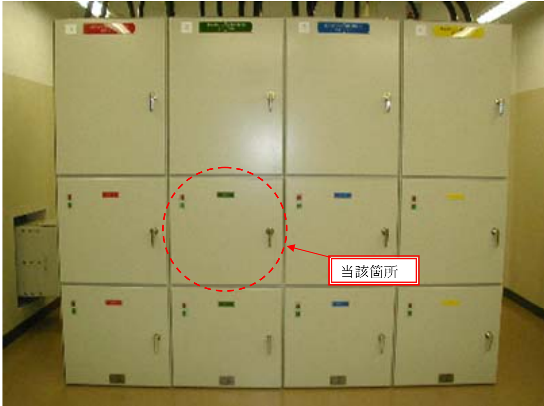
原子炉トリップ遮断器盤
