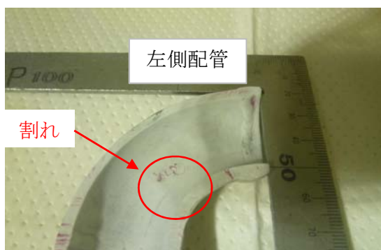
【割れ箇所④】
