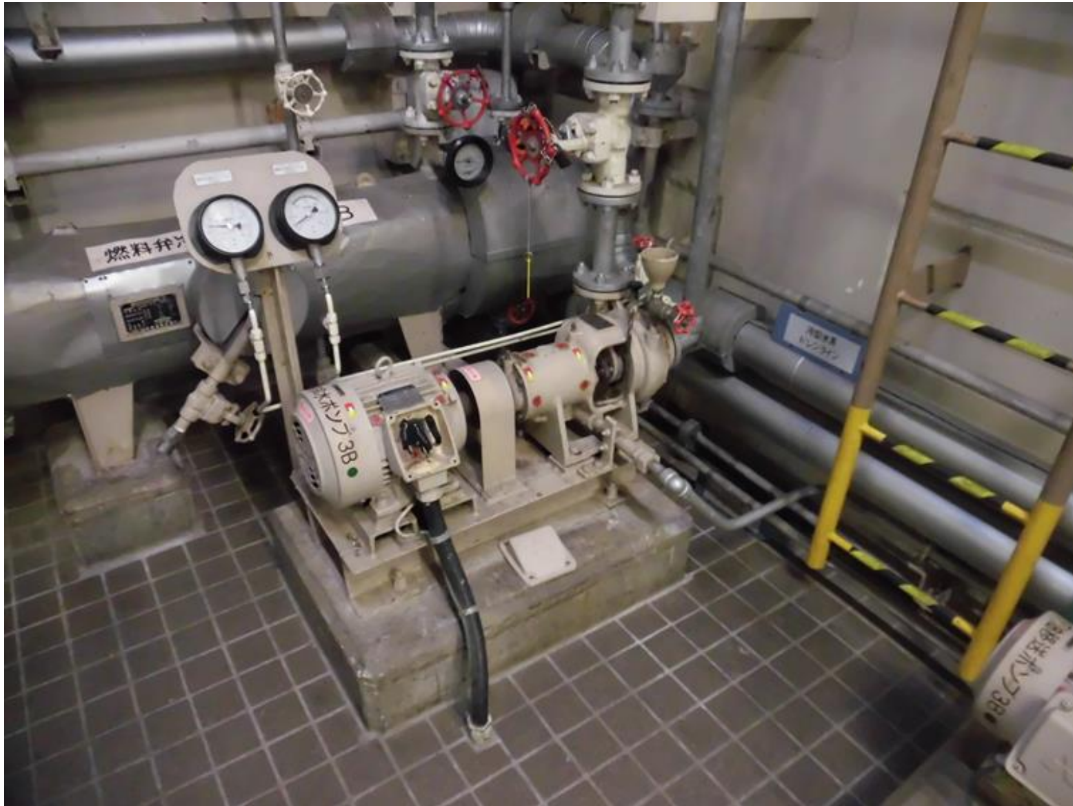
燃料弁冷却水ポンプ 3 B
