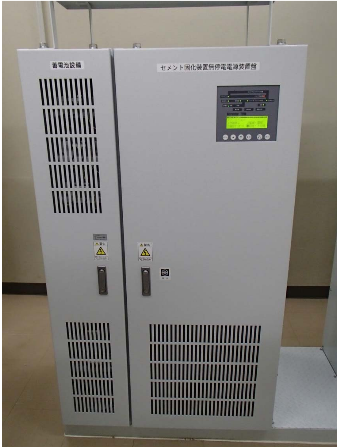
セメント固化装置無停電電源装置盤 3号
