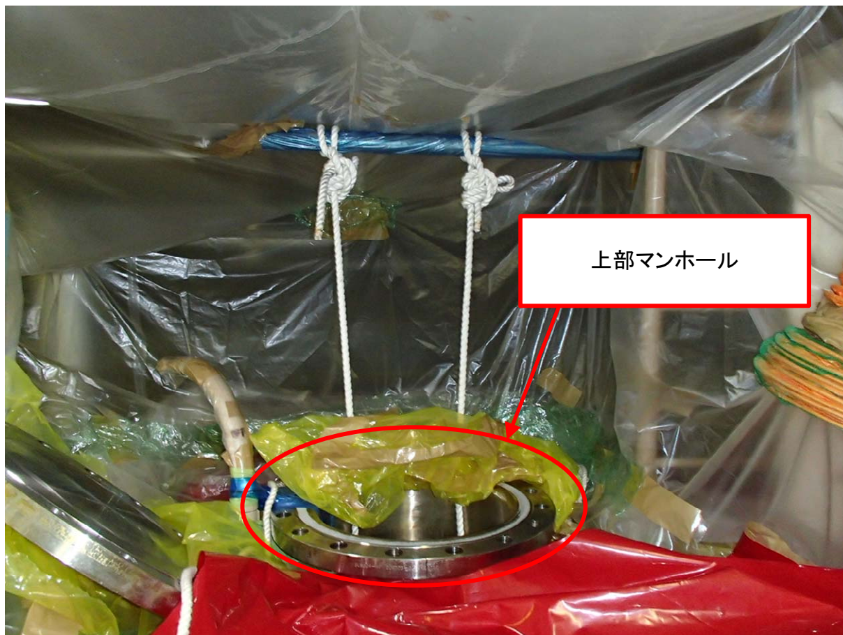
ほう酸タンク3B タンク上部の状況
