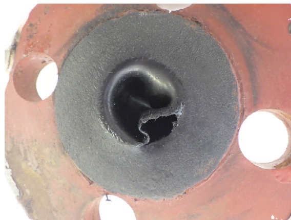
(参考) 今回漏えいした箇所
