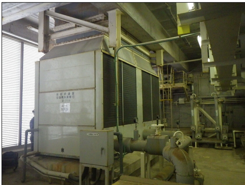
冷凍機B全景
