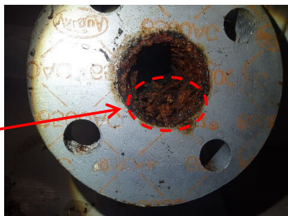
逆止弁内面ユニット側 (矢視③)
