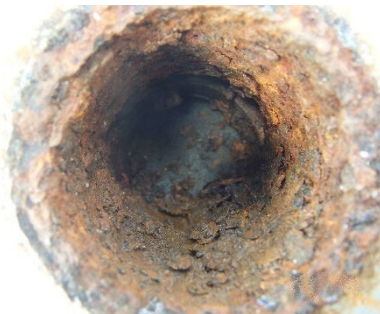
逆止弁内面ユニット側 (矢視②)
