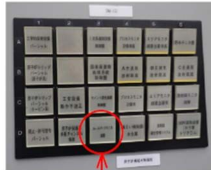
「ルースパーツモニタ装置」消灯
